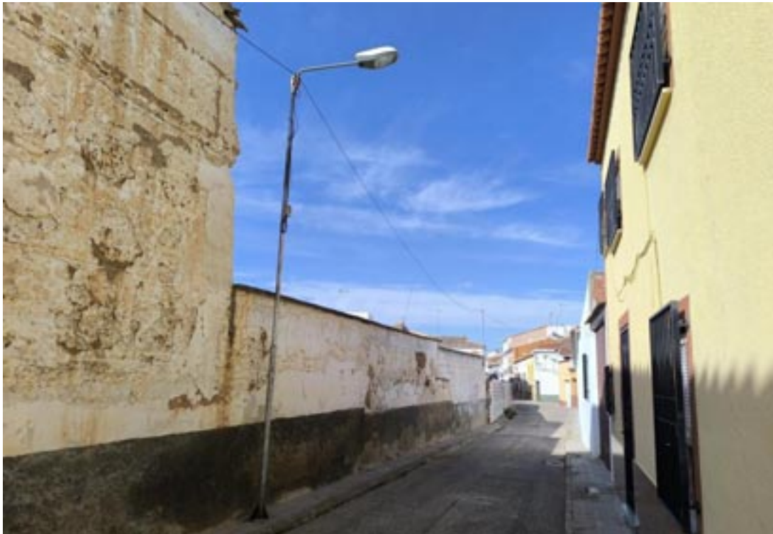
Continuación por calle Virgen de la Esperanza. Cerramientos en mal estado, nula accesibilidad y elementos inadecuados y mal colocados (farola, cerramiento de chapa invadiendo acerado...)
