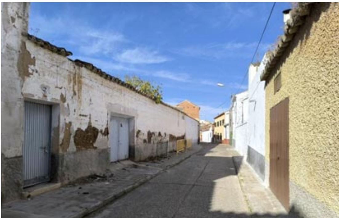
Continuación por la calle Virgen de la Esperanza. Acerados con mala accesibilidad, cerramientos en estado de abandono con vallas disuasorias y portones metálicos inadecuados. Pavimento de asfalto.
